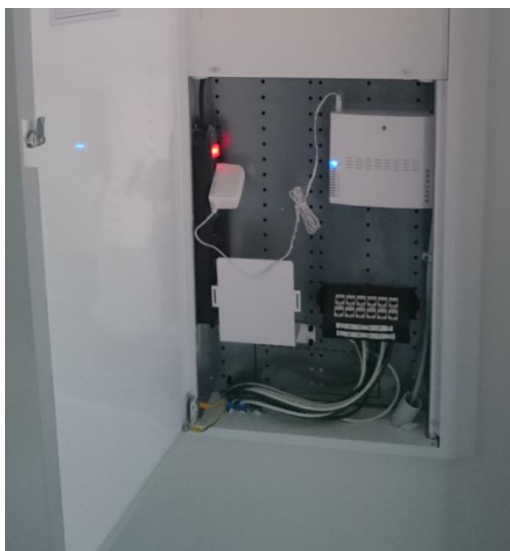
I skåpet finns plats för ev telebox eller ytterligare switch/modem. Tre patchkablar levereras med som standard.
